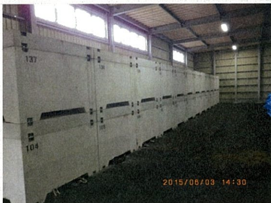
仮設建物内コンクリートボックス（建物外側は車両通行の妨げとなるため内側に24個格納）
