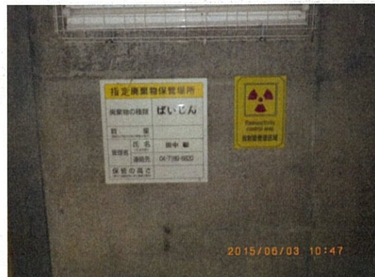
主管廊配管エリア 掲示板
