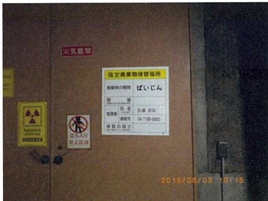
脱水機室保管場所掲示板
