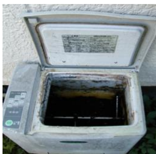
装置の外観（屋外設置、7年使用）
