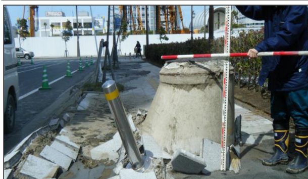
東日本大震災における被災状況
