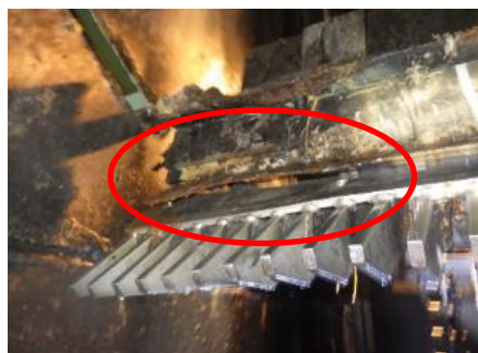
レーキ部分の腐食、変形
