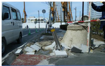
液状化被害（実績）
