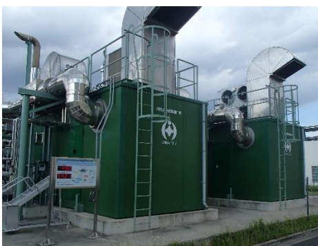
消化ガス発電設備
