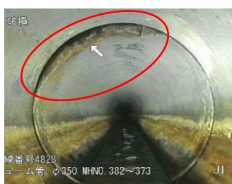
緊急度 II (破損)
