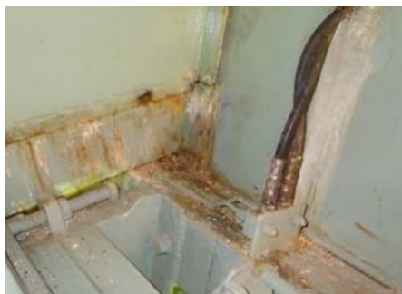
ケーシング部分の腐食
