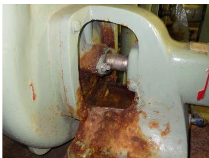
ケーシング部分の腐食
