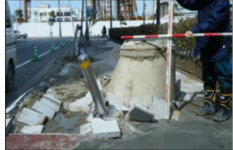
東日本大震災被災状況（美浜区）
