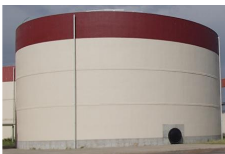
汚泥消化タンク
