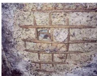
緊急度 I (腐食)
