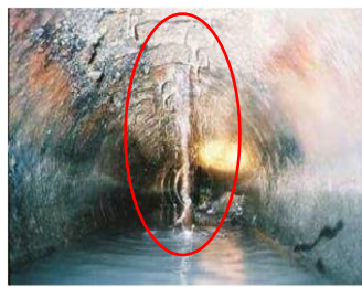
緊急度 II (浸入水)
