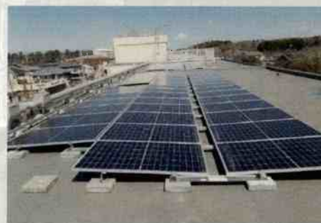
太陽光パネル
