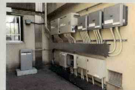
蓄電池・パワーコンディショナー等
