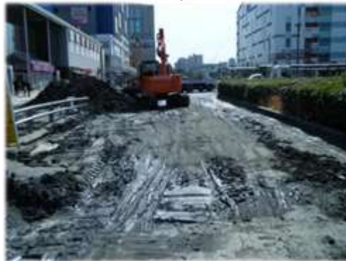
駅前広場の舗装隆起・土砂流出 歩道に被害多
