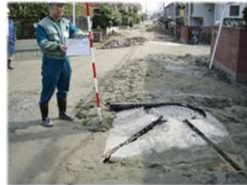
生活道路の隆起・沈下 土砂流出 占用物(下水)の破損 家屋被害多
