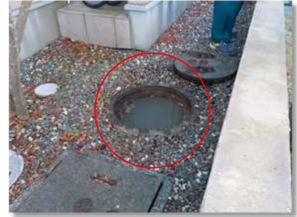
【汚水取付管の詰まり】
