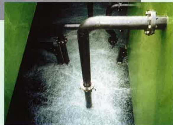
① 生物処理槽 生物処理（接触ばっ気法）によって、浸出水中のBOD、COD及び窒素成分を除去します。
