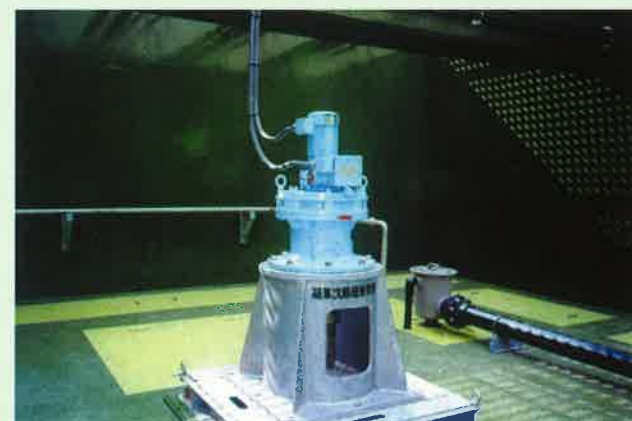
② 凝集沈殿槽 生物処理槽の浮遊物(SS)と汚濁物質(COD系)を凝集沈殿除去します。
