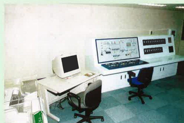
⑤ 監視室 流入から放流までの、全ての運転はここで集中管理していますので、迅速かつ的確な対応が可能です。
