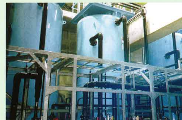
③ 高度処理 凝集沈殿槽で処理した処理水を更に高度処理するため、砂ろ過、活性炭吸着塔を通してSS、CODや色度成分を除去して清澄な処理水とします。
