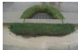
ウッドチップフィルター設置例
