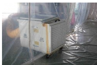
②-2 負圧除塵装置設置例
