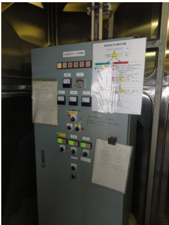
非常用井戸ポンプ制御盤
