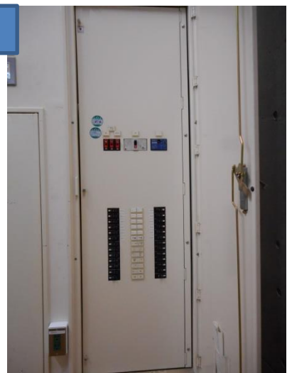
分電盤 L-A2 内部
