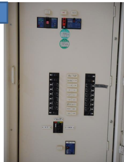
分電盤 L-A1 内部
