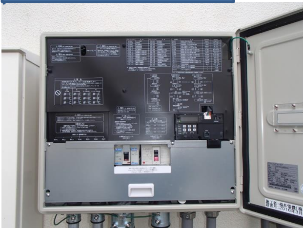
パワーコンディショナ（電灯）
