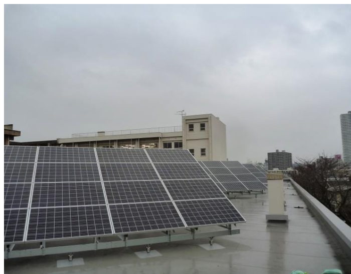
太陽光パネル(20kW) 京セラ製 校舎屋上
