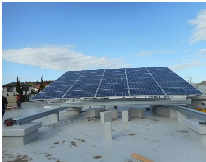
太陽光パネル(7.5kW) 京セラ製 建屋屋上
