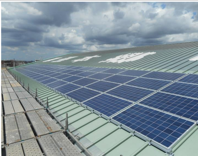
太陽光パネル(20kW) シャープ製 体育館屋上
