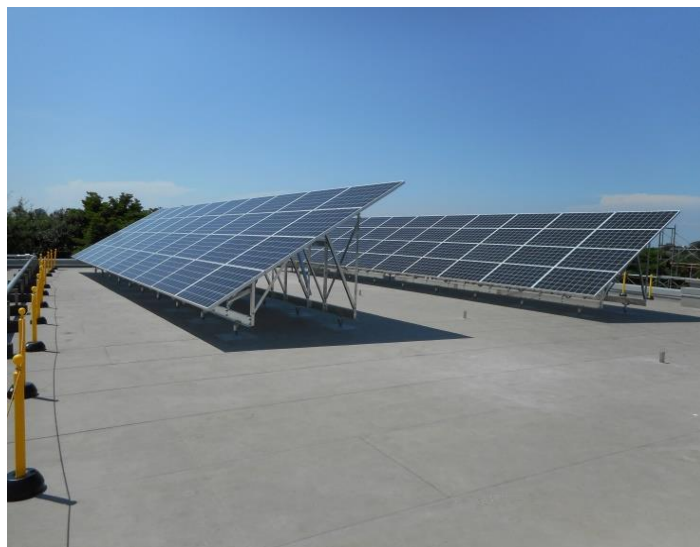
太陽光パネル(10kW) 京セラ製 校舎屋上
