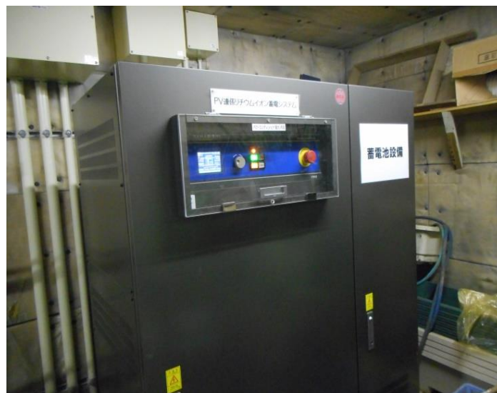
蓄電池(15kW) YAMABISHI製 機械室内
