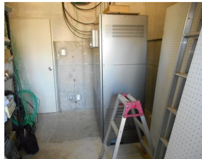
蓄電池(10kW) YAMABISHI製 機械室内
