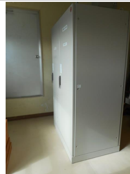
蓄電池(15kW) ソニー製 体育館3F倉庫内
