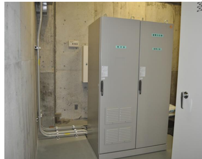
蓄電池(15kW) ソニー製 電気室内
