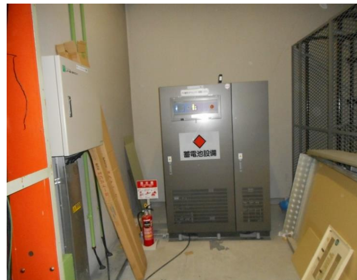
蓄電池(15kW) YAMABISHI製 電気室内
