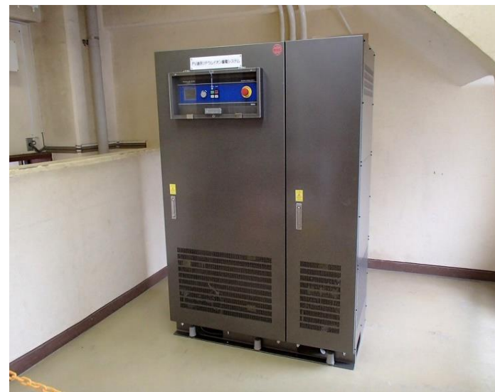
蓄電池(15kW) YAMABISHI製 体育館内
