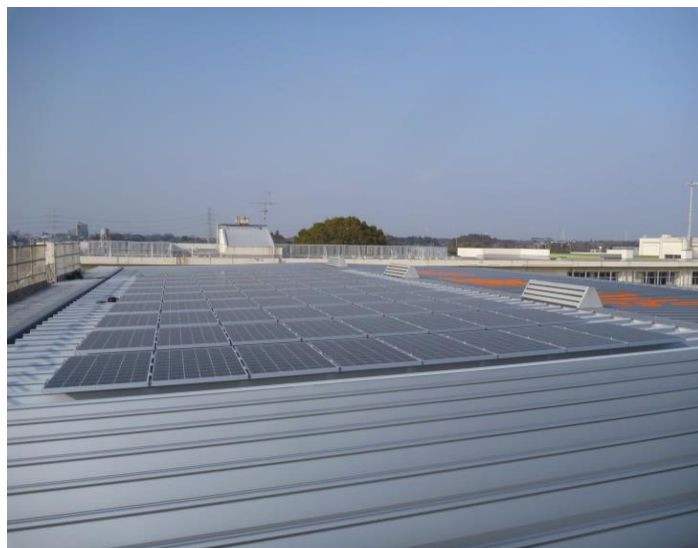
太陽光パネル(20kW) 京セラ製 体育館屋上
