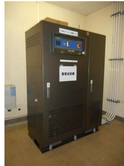
蓄電池(15kW) YAMABISHI製 電話交換室内
