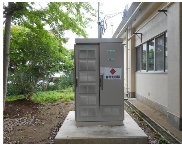
蓄電池(15kW) ソニー製 屋外
