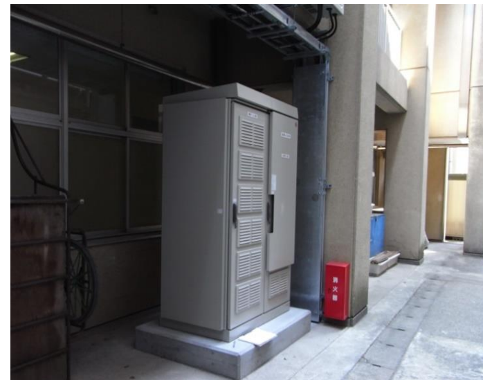
蓄電池(15kW) ソニー製 屋外
