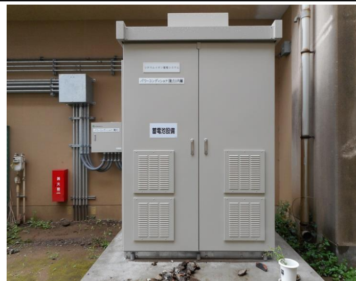
蓄電池(15kW) YAMABISHI製 屋外
