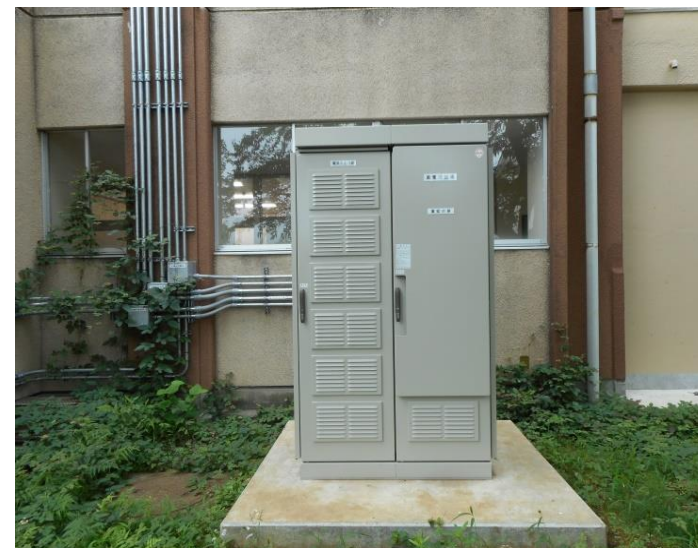
蓄電池(15kW) ソニー製 屋外
