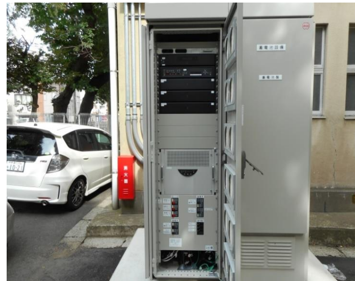
蓄電池(15kW) ソニー製 屋外
