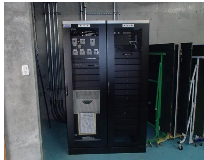
蓄電池(15kW) 平河ヒューテック製 体育館内
