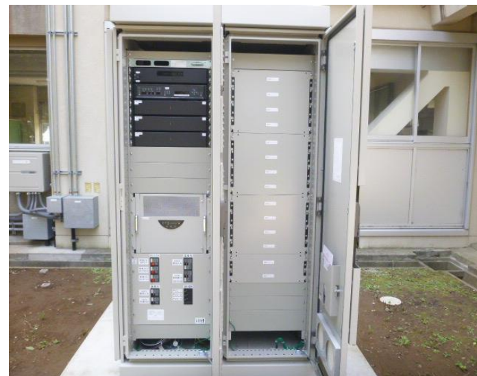
蓄電池(15kW) ソニー製 屋外
