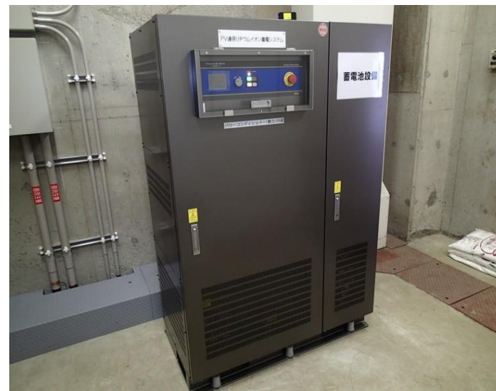
蓄電池(15kW) YAMABISHI製 電気室内
