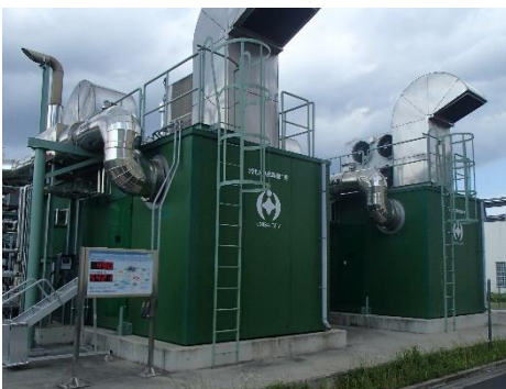
消化ガス発電設備
