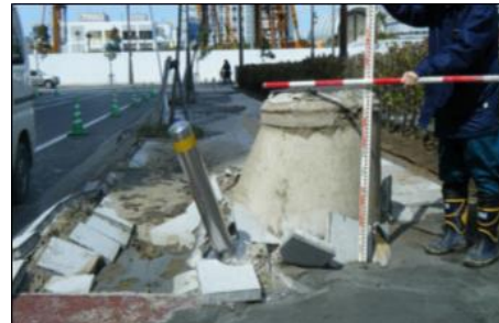
東日本大震災被災状況（美浜区）
