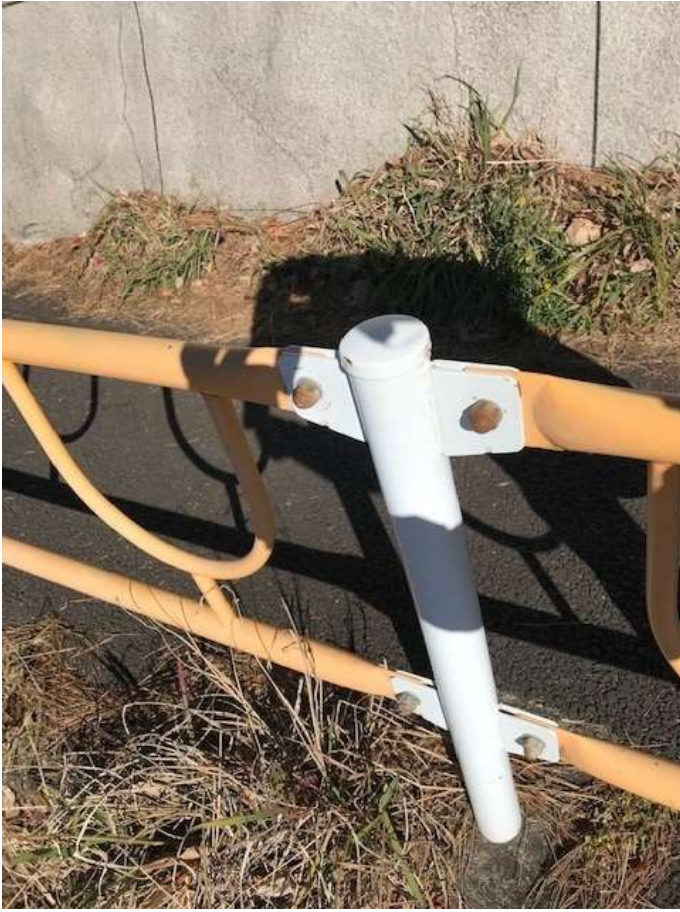
歩道安全柵③
