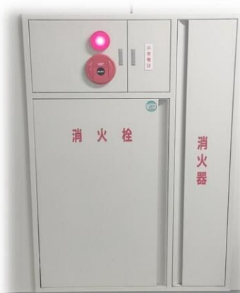
屋内消火栓設備
