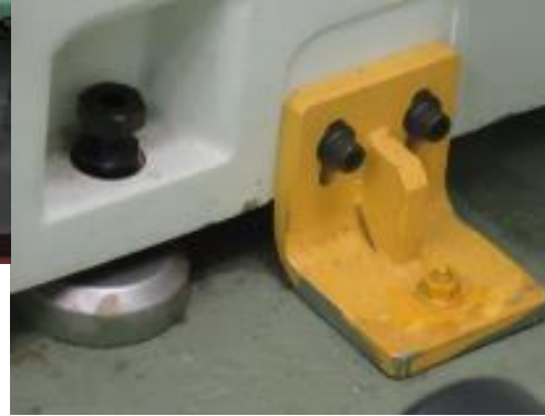
機器の倒壊・ズレ防止
