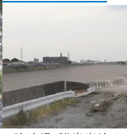
▲防波堤・護岸崩壊
