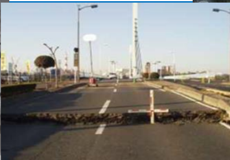
▲橋と橋の取り付け道路の段差
