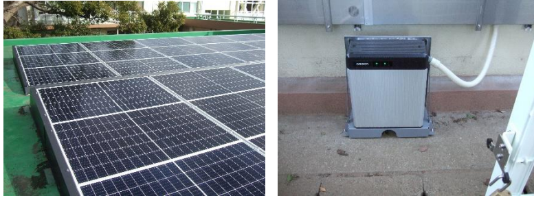
校舎に設置されている太陽光発電設備（左）及び蓄電池（右）
