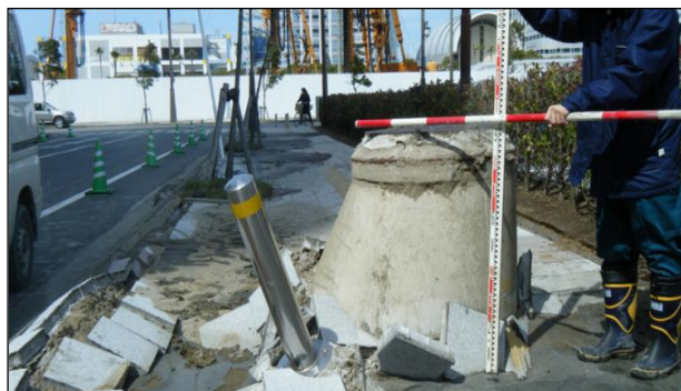
東日本大震災における被災状況
