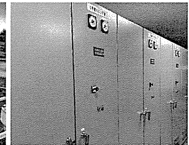
No.8 動力設備
