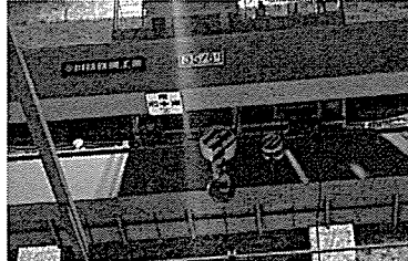
No. 16 原動機室天井クレーン
