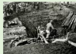
発掘現場：泥炭地で崩れやすいので土留めをして掘削している
