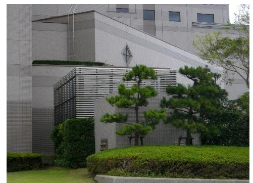
屋外設備を建築物本体と調和する柵によって遮蔽し、調和を図っている。
