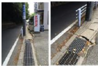
①歩道の段差 解決前
