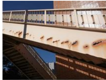
老朽化の状況
