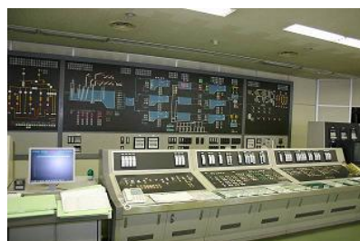
(南部浄化センター集中監視室)
