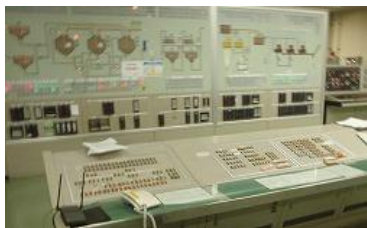
(汚泥監視制御設備)
