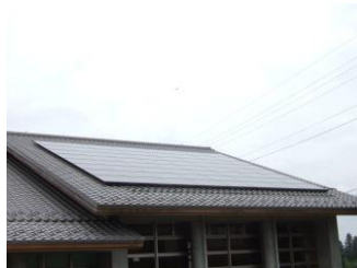
太陽光発電設備
