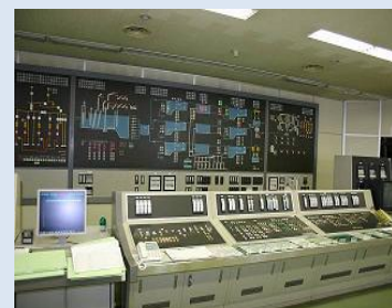
(南部浄化センター：集中監視室)
