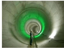
(中央雨水1号貯留幹線)
