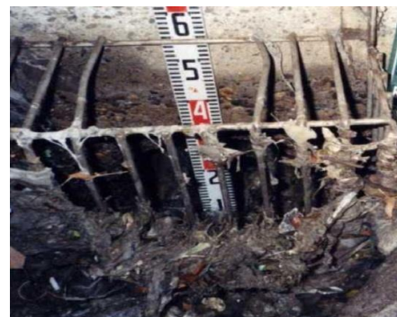
(マンホール内のスクリーンに溜ったきょう雑物)
