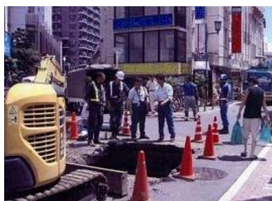
(市街地での道路陥没)
