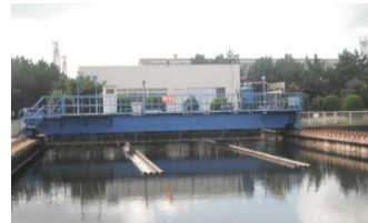
(最終沈殿池・採泥機)
