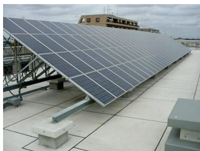
(学校屋上の太陽光発電)
