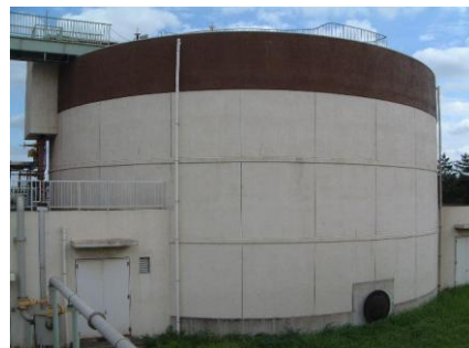
(既設消化タンク)
