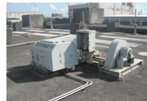
(最初沈殿池・汚泥掻寄機)
