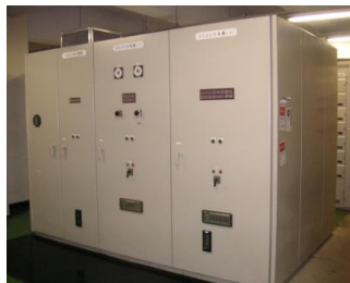
(配電盤設備・全景)
