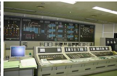
(南部浄化センター集中監視室)
