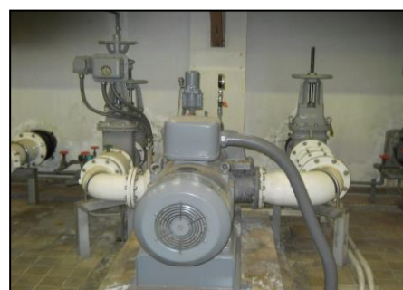
平川浄水場配水ポンプ
