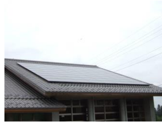
太陽光発電設備
