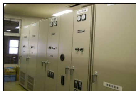
平川浄水場計装設備
