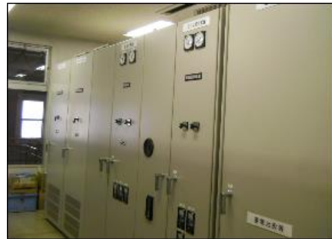
平川浄水場計装設備
