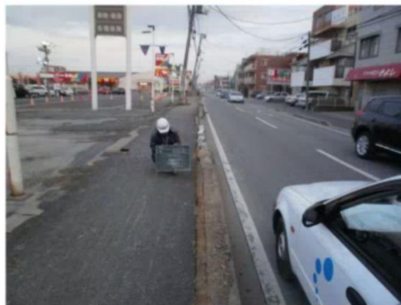
液状化による電柱の傾斜 (市内) 10
