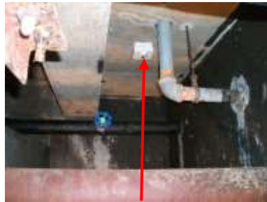
ガス漏れ警報器設置位置
