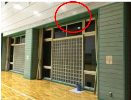
体育館窓際中央付近雨漏り
