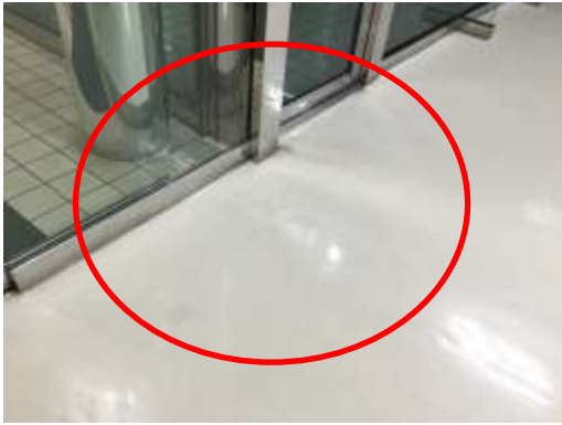
体育館棟側入口暴風雨による水溜り
