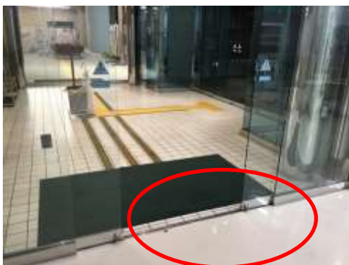
正面入口風除室内暴風雨による水溜り
