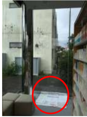
図書室奥側雨漏り
