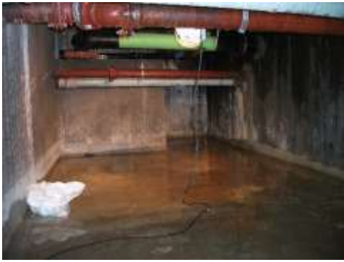
スラブ（天井）・排水管・壁面が結露
