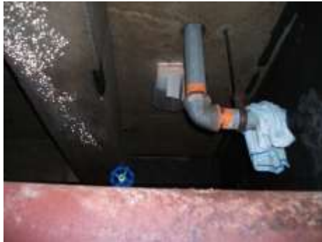
スラブ（天井）・排水管・壁面が結露。
