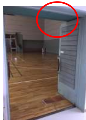
体育館入口側雨漏り
