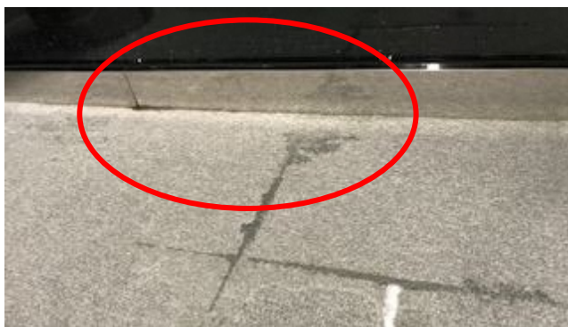
図書室右奥側 目地のところから雨漏り ※外のコーキングは確認したが目視では問題ない状況
