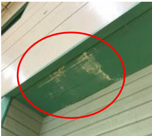
体育館入口側 真ん中のベンチ上 天井から雨漏り
