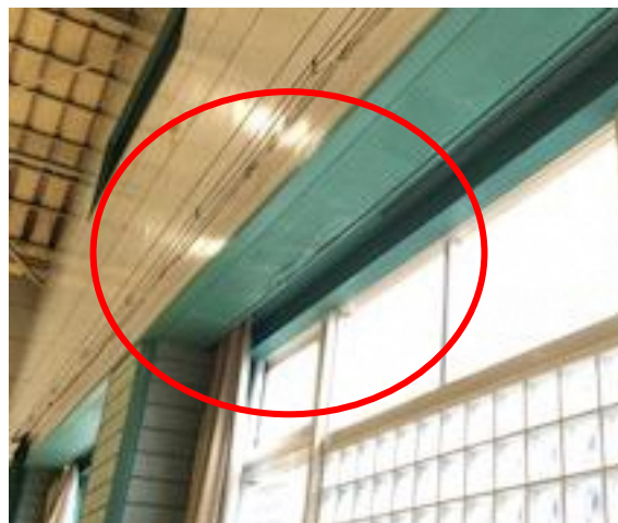
体育館線路側 真ん中 天井から雨漏り
