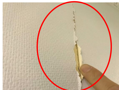
ボードにもクラックが入っている
