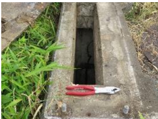
コンクリートの内部は空洞
