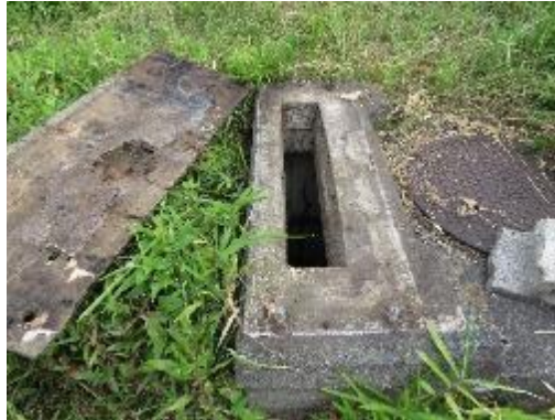
木の蓋が腐食
