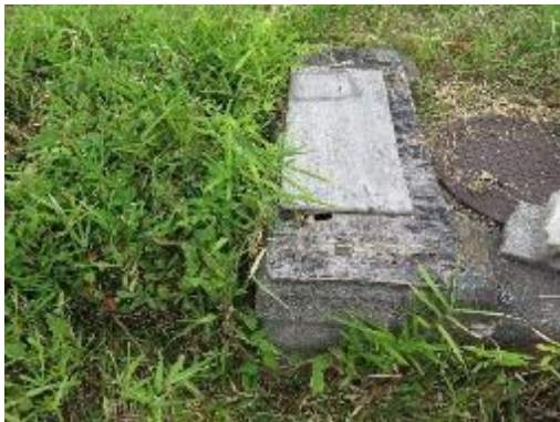
旧受電設備跡の蓋部分に穴が開く
