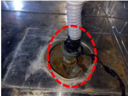
フレキホースと排水管の継ぎ目から漏水
