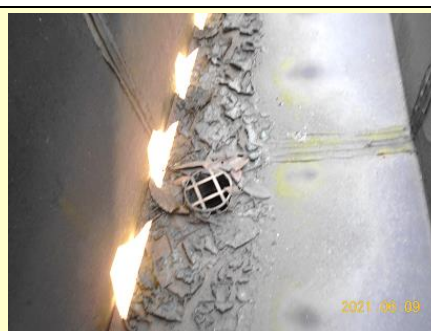
● 清掃前の状況(2年分の汚れあり)
