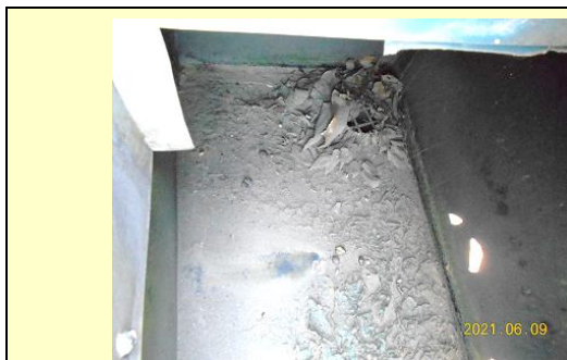
● 清掃前の状況(2年分の汚れあり)
