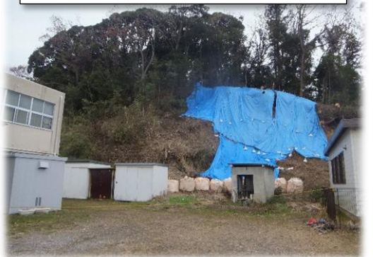
大雨で裏山が崩壊（椎名公民館）
