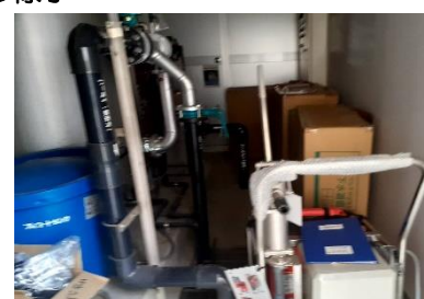
仮設発電機や各種資機材場所の確認
