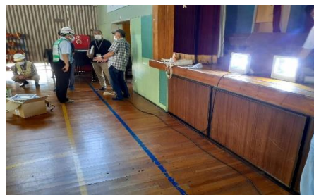
仮設発電機の電源からLED照明供給
