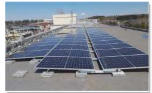
太陽光パネル (花見川小学校)
