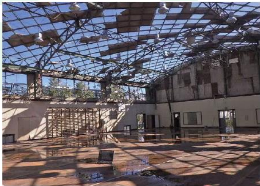
屋根が吹き飛んだ体育館
