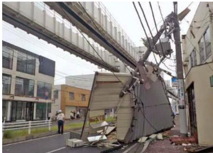
道路上に倒壊したプレハブ
