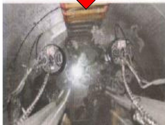
マンホールポンプ場 (143施設)
