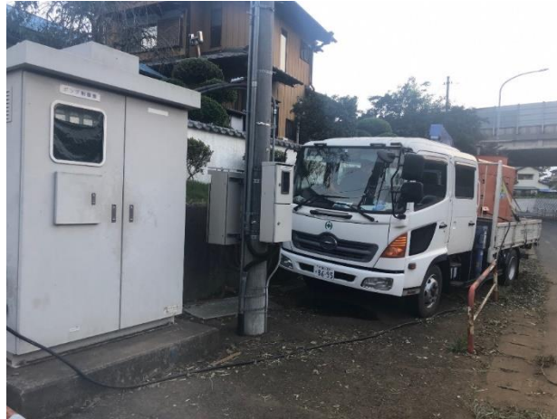
令和元年台風15号 可搬式発電機によるポンプ場運転
