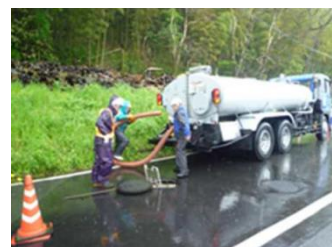
③熊本北部流域下水道のマンホールへし尿投入
