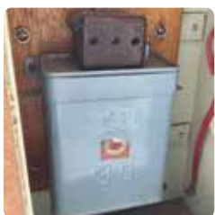
電力用コンデンサー
