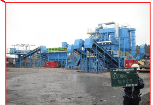
可燃・不燃 ベルトコンベヤ
