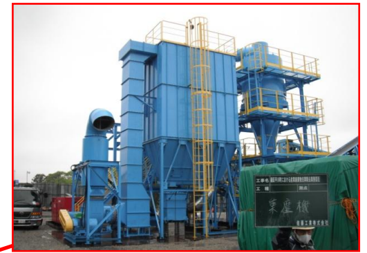
集塵機 サイクロン
