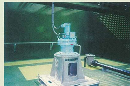
③ 凝集沈殿槽 生物処理槽の浮遊物(SS)と汚濁物質(COD系)を凝集沈殿除去します。
