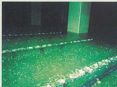
② 調整槽 調整槽で浸出水を一時貯留して、水量変動を調整するとともに水質を均一にするためにばう気を行います。
