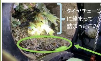
＜詰まりが生じた輸送管内部の様子＞
