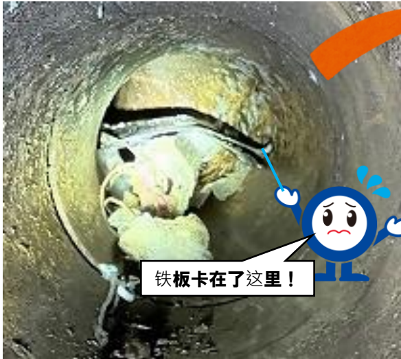
令和5年12月发生的堵塞情况
