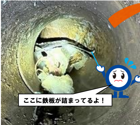
令和5年12月の詰まり状況
