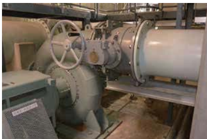
千葉県水道局幕張給水場
