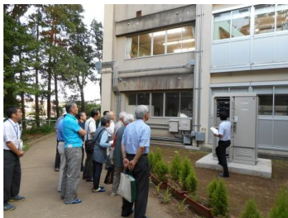
手順書説明会(設備確認)
